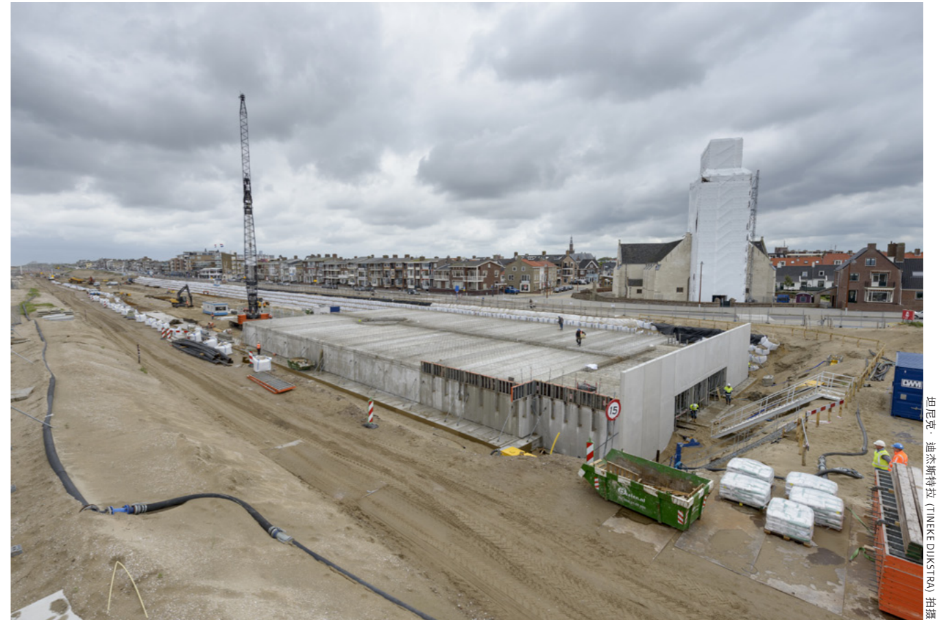
多功能堤坝： 创新性的空间节省方案： 在卡特韦克 (Katwijk) 的堤坝 内修建了地下停车场。
